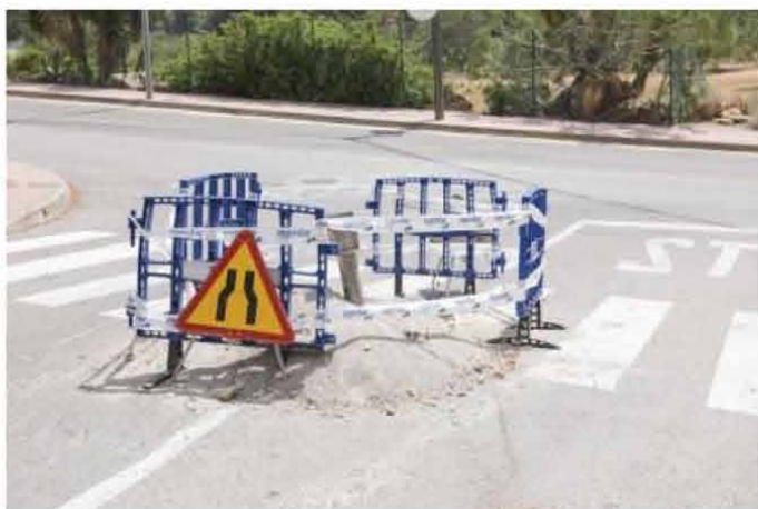
Vecinos destacan que el problema tiene que ver con el aumento de la presión, que rompe las tuberías. | Toni Planells
